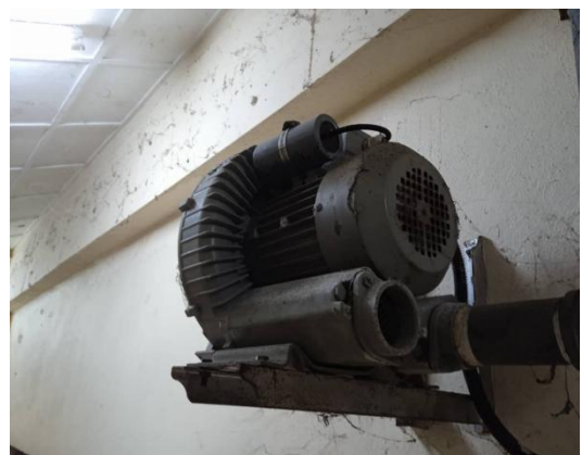
“Aerator” jenis vortex blower
