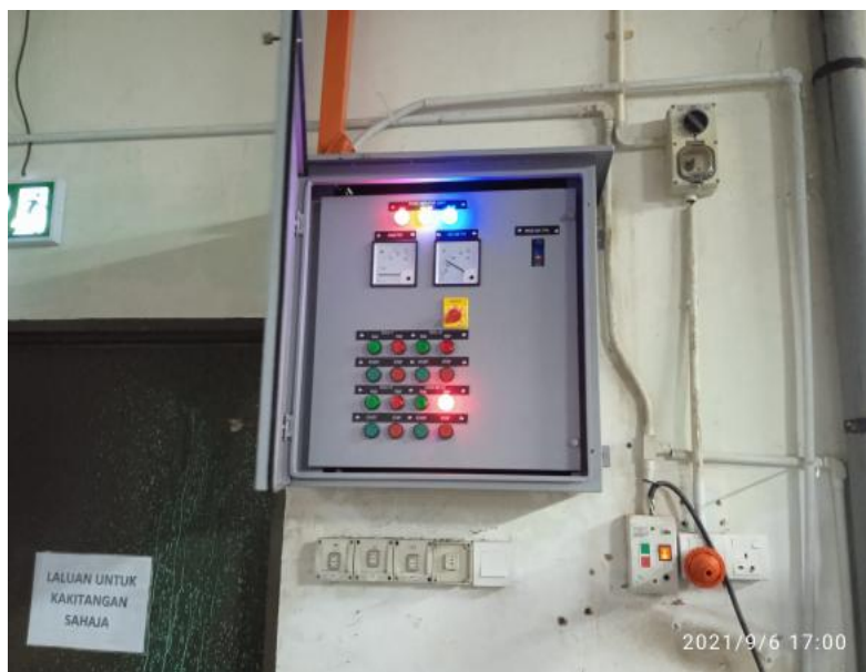
Panel pengagihan bagi bekalan elektrik
