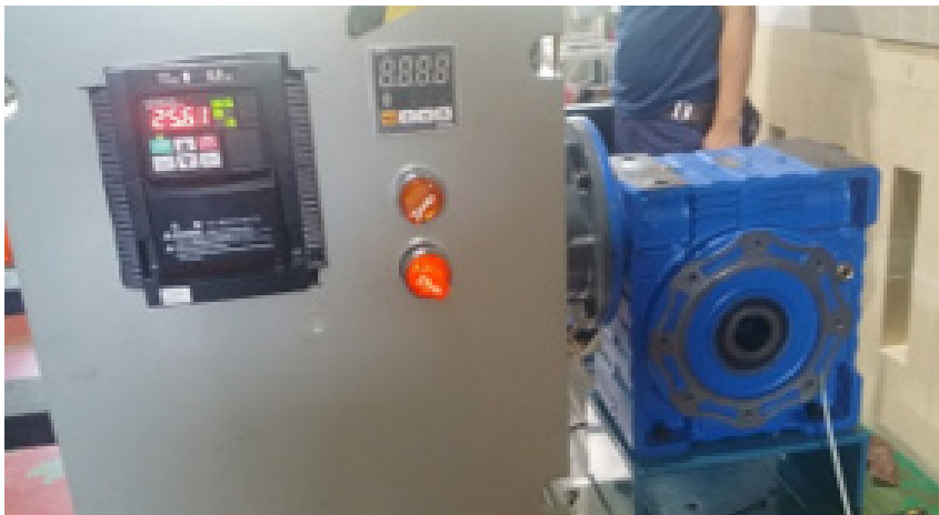
Panel kawalan dipasang inverter berkuasa 2.2kW 1- ke 3-fasa dengan motor bergear jenis aruhan 3kW (4hp).
